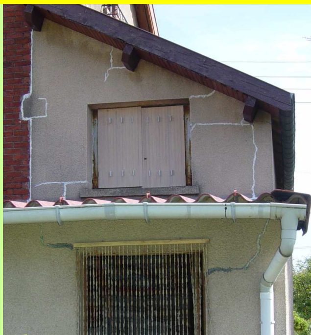
Dégâts provoqués par un affaissement lent et progressif.
