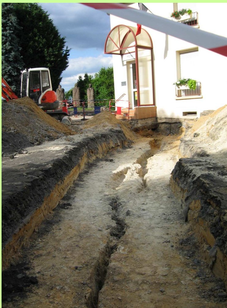
Traitement d'une crevasse minière devant la mairie de Rosbruck en juillet 2009
